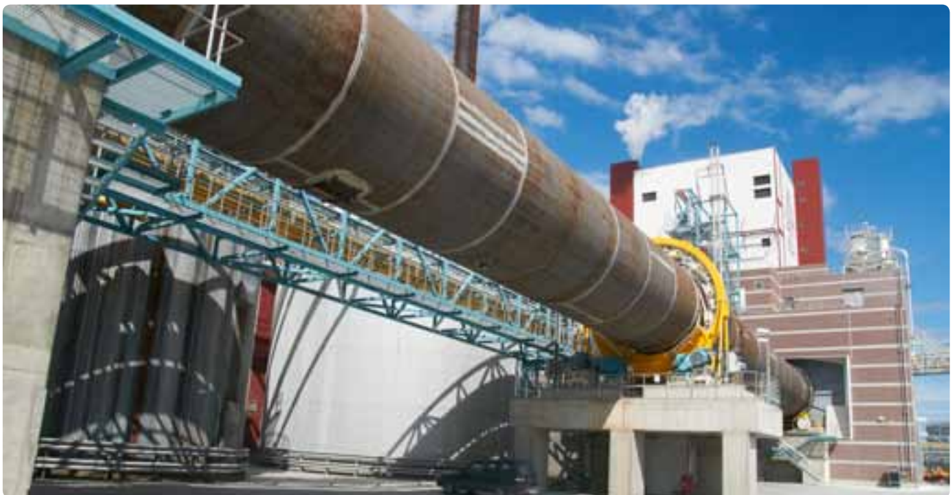
Installationen av en biobränsleeldad mesaugn vid Östrands massafabrik minskade koldioxidutsläppen med 50 000 ton jämfört med de förra oljeeldade ugnarna.
