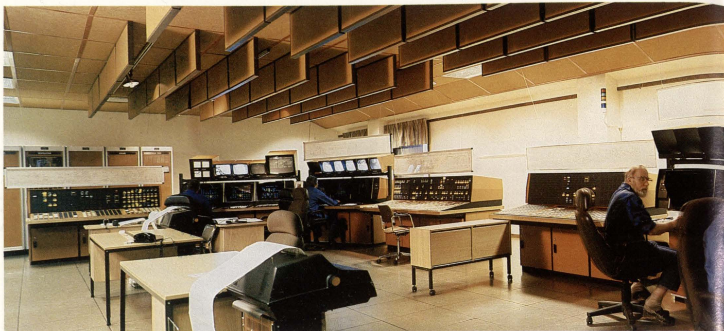
Vid moderniseringen av Östrands sulfatfabrik har installerats avancerade databaserade system för information om samt styrning och kontroll av processen. Bilden visar manöverrummet för process-avsnitten kokning, silning, tvättning och blekning.
