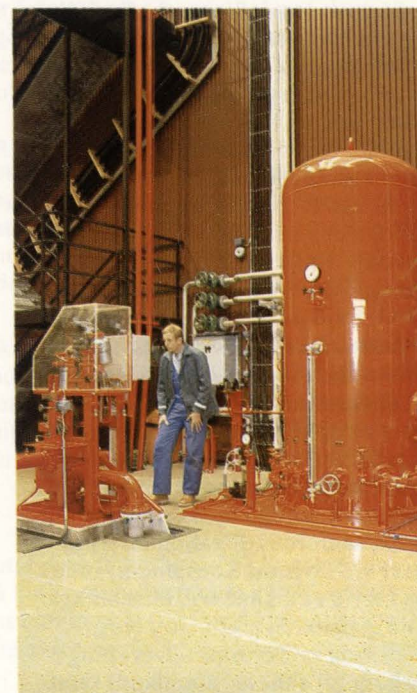
Maskinsalen i Viforsens kraftverk.
